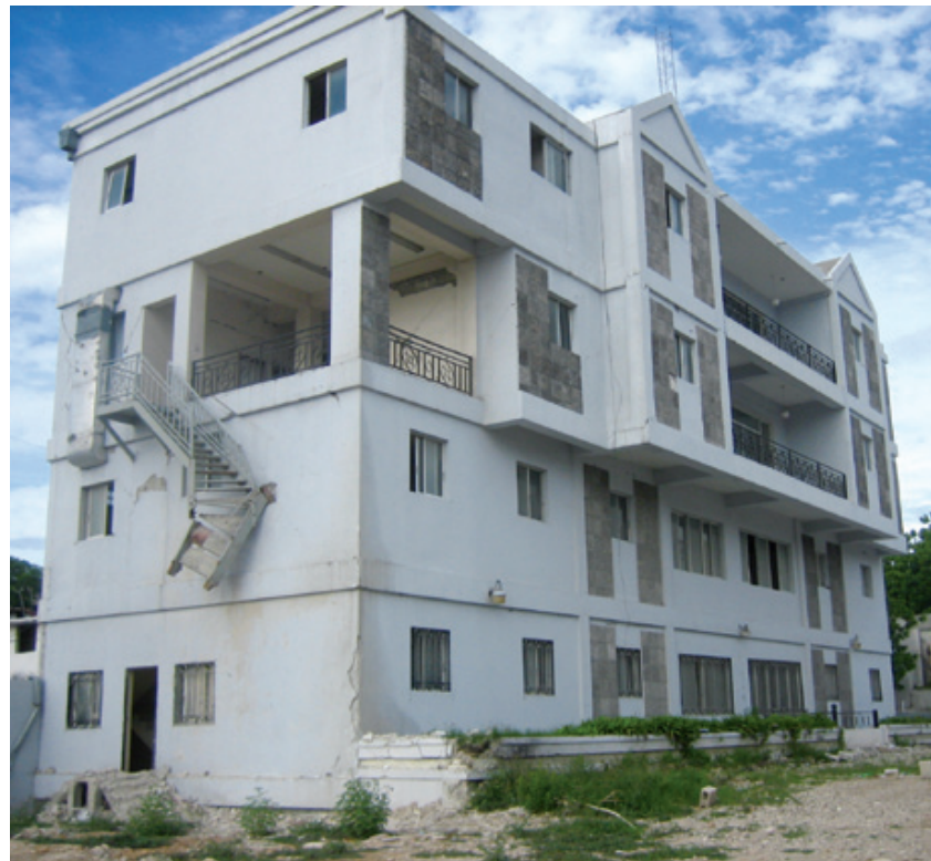
Bâtiment antisismique selon les règles PS92 ayant subi un séisme majeur - © Vincent Courtray - MEDDTL
