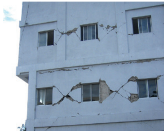
Effets d'une sollicitation sismique dans la maçonnerie - © Vincent Courtray - MEDDTL
