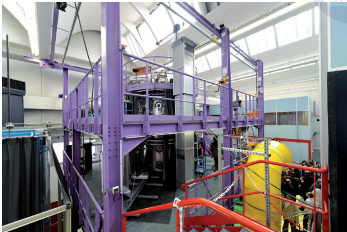
Installation Tosqan, pour l'étude des risques liés à une combustion violente d'hydrogène provoquant l'endommagement de l'enceinte de confinement d'un réacteur ou système de sûreté (CEA de Saclay) - © Arnaud Bouissou - MEDDTL
